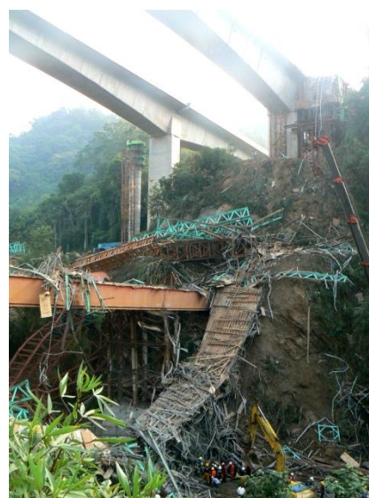
圖 2 國道六號南投北山交流道橋樑工程 模板支撐倒塌
