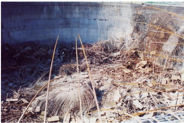
圖 1 高雄大岡山北嶺加壓站配水池工程 模板支撐倒塌
