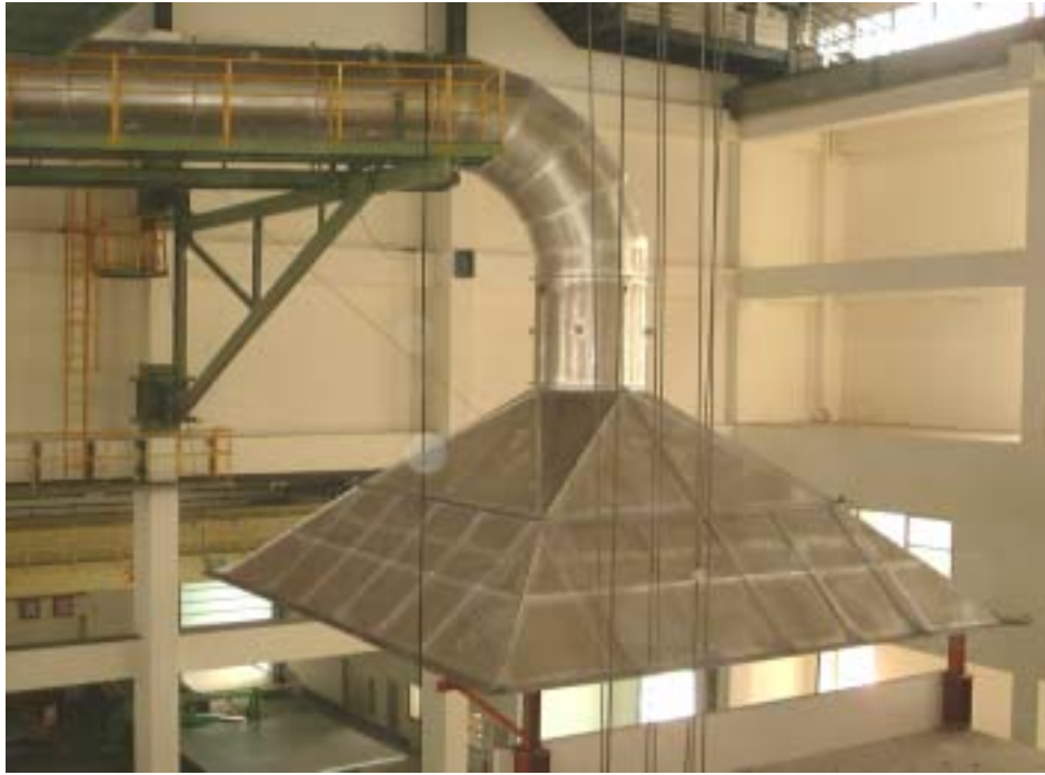
(a) 集煙罩與排煙管路
